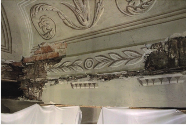
Pałac w Dobrzycy. Fragment sklepienia. Stan przed konserwacją, fot. Robert Rogal
