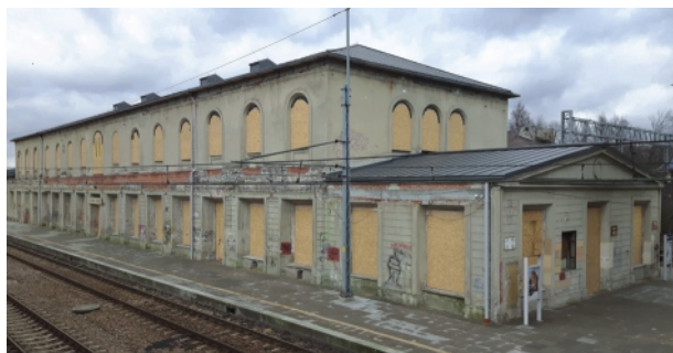
Sosnowiec-Maczki. Dworzec kolejowy – widok na południowo-wschodnią część obiektu po przerwaniu prac remontowych, fot. Jacek Jakubek
