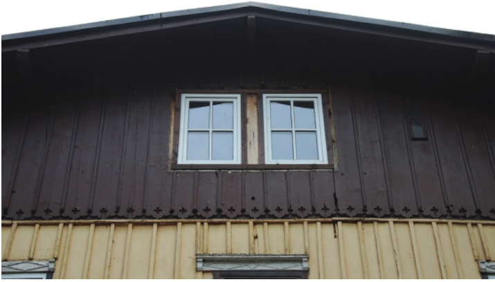
Goczałkowice-Zdrój, dawny Kurhaus, ul. Uzdrowska 54, ok. 1862 r. Okna poddasza w szczycie elewacji północnej skrzydła północnego budynku, fot. Maria Kołek
