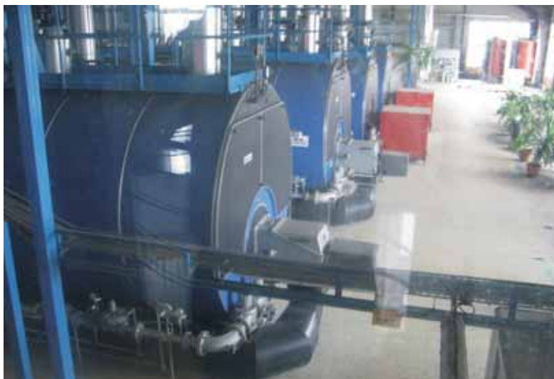
Rys. 13. Hala ciepłowni geotermalnej w Pyrzycach (fot. B. Igliński)
