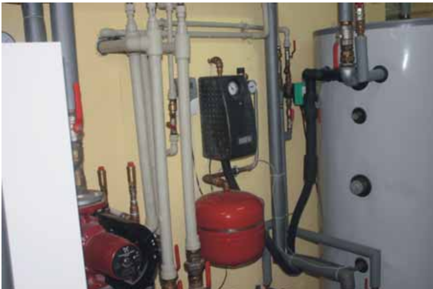
Rys. 3. Przyłącza instalacyjne pompy ciepła i sprzężonych z nią kolektorów słonecznych [6, 8]
