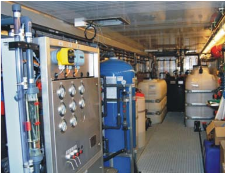
Rys. 7. Instalacja odwróconej osmozy
