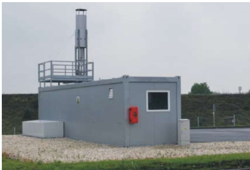
Rys. 6. Moduł przygotowania biogazu
