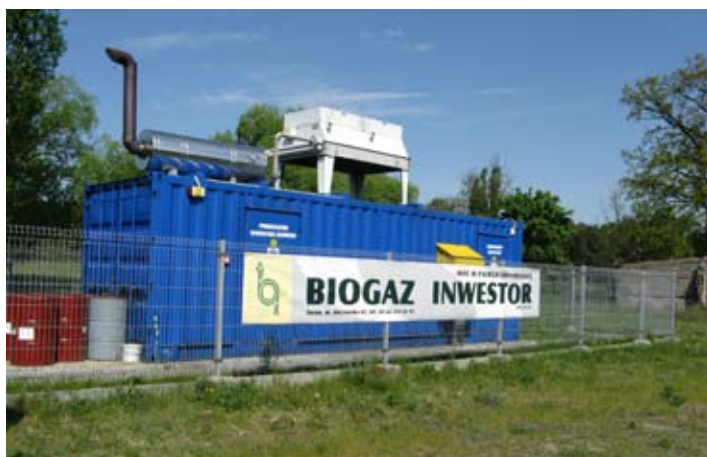
Rys. 3. Kontener z agregatem prądotwórczym AP-2 marki MDE o mocy 324 kW e (fot. B. Igliński)
