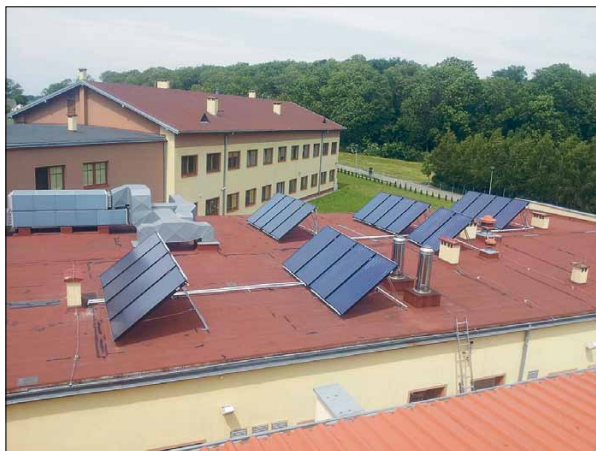
Rys. 14. Kolektory na dachu szkoły w Turznie [15]
