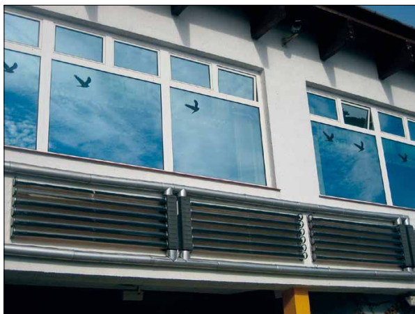
Rys. 12. Kolektory rurowe na Ośrodku Edukacji Ekologicznej „Wilga” w Górznie (fot. R. Koję)
