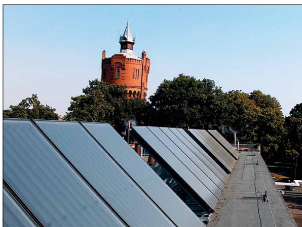
Rys. 13. Kolektory słoneczne w Wojewódzkim Szpitalu im. L. Rydygiera w Toruniu [14]
