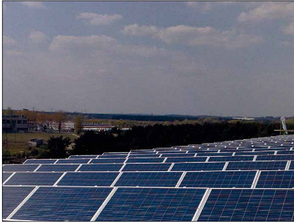
Rys. 16. Instalacja fotowoltaiczna, firma FRoStA, Bydgoszcz [23]
