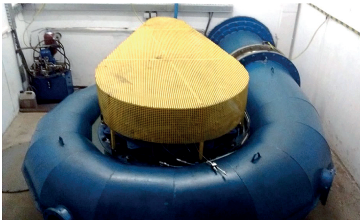
Rysunek 1.4. „Serce” hydrozespołu z turbiną Francisa w elektrowni wodnej w Toruniu
