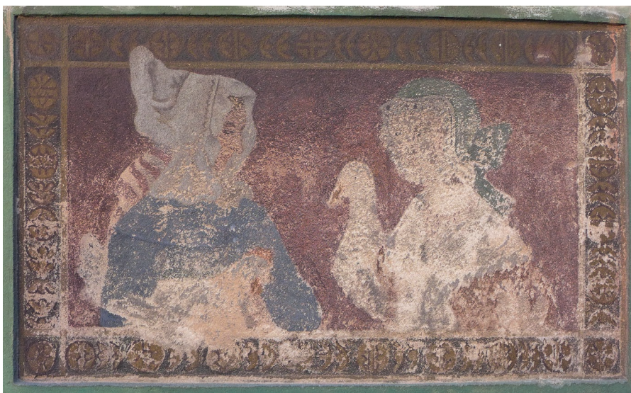
Fot. 5. Gdańsk, kamienica przy ul. Długiej 1. Fasada, malowidło w lewym polu nad oknami parteru – wygląd przed przystąpieniem do prac w 2015 r. Fot. Anna Żychska
