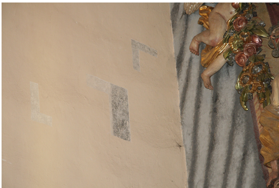
3. Dzierzgoń, kościół pw. Trójcy Przenajświętszej. Północna ściana prezbiterium. Wykonane odkrywki jednoznacznie pokazują, że malowana kotara, stanowiąca tło ołtarza głównego, zachodzi na ściany boczne. Fot. K. Szczepińska
