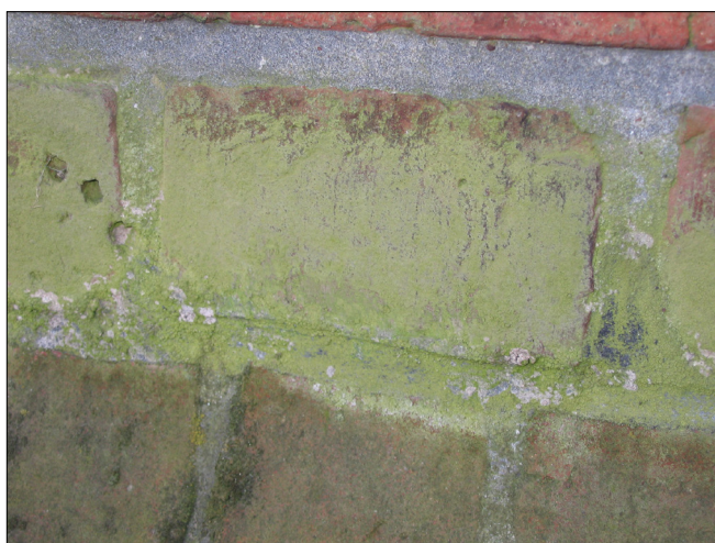
Fot. 2. Zielona warstwa glonów aerofilnych na powierzchni cegieł i zaprawy (fot. J. Łukaszewicz)
