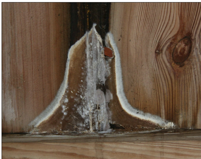
Fot. 8. Owocnik stroczka łzawego na drewnianej ścianie (fot. K. Polak)
